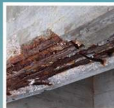
CORROSÃO NO CONCRETO ARMADO
